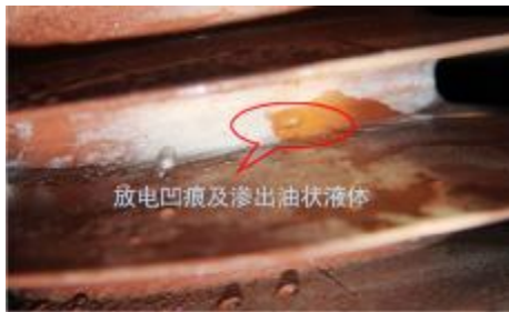
图 2 故障均压电容器现场检查
